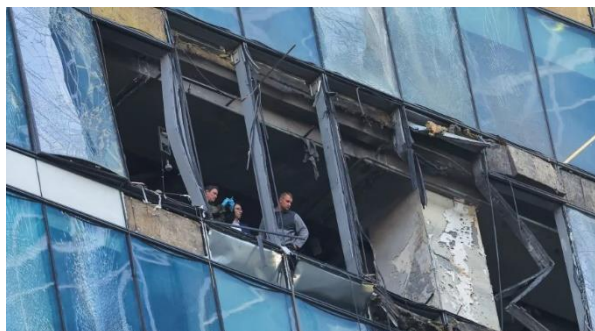
Membros dos serviços de segurança investigam um prédio de escritórios danificado na cidade de Moscou após um ataque de drone ucraniano relatado em Moscou, Rússia, em 1º de agosto de 2023.
